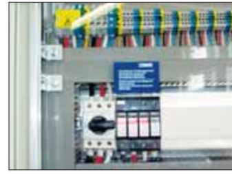
Die PEZAG Elektro AG setzt auf Überspannungs-Schutzgeräte der Phoenix-Contact AG.
